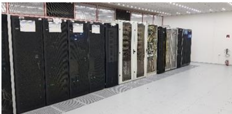
← Dátové centrum na GKÚ
